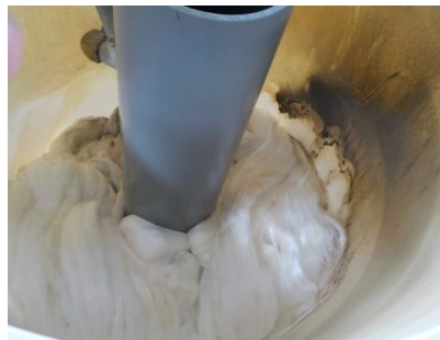
ドレン分離槽内部
